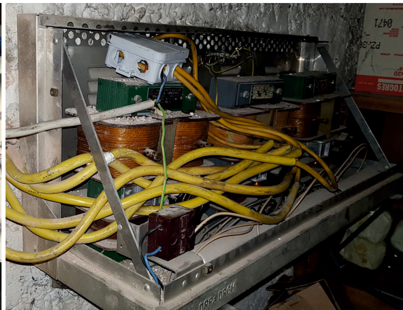
Alte Technik in Transformatorkasten einer Neonanlage
